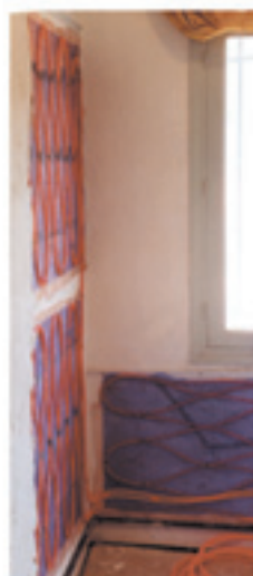
Riscaldamento a parete
